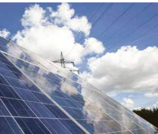
Solarstromanlage im Netzverbund.
