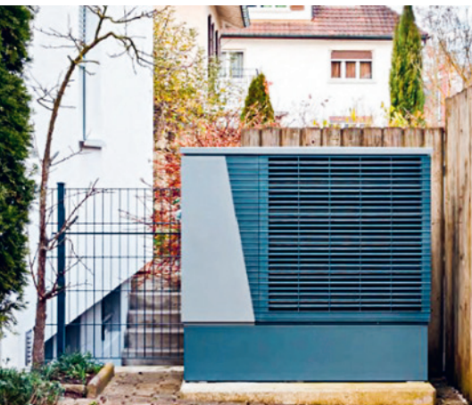
Aussen aufgestellte Luft/Wasser-Wärmepumpe.
